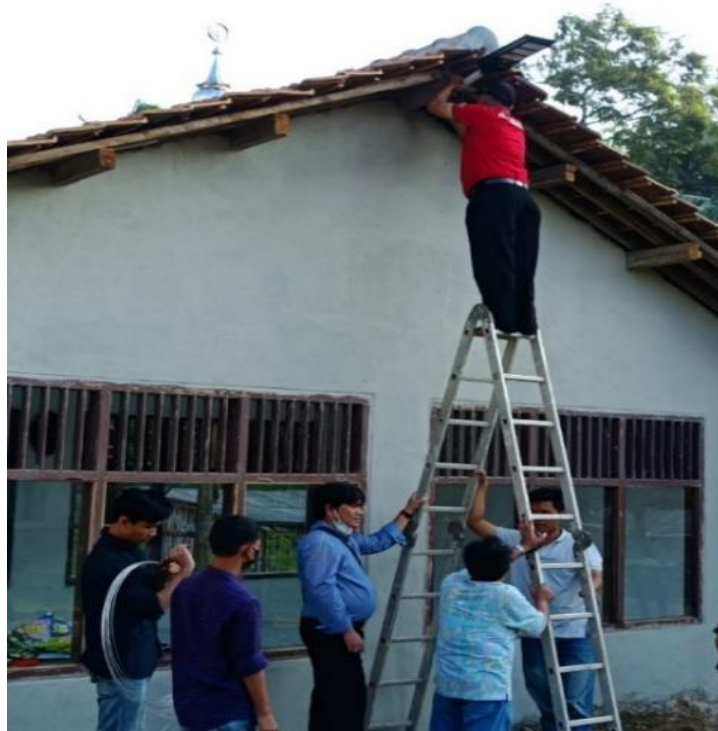
Gambar 5. Pemasangan penerangan system tenaga surya di salah satu titik dekat Mushola di Desa Nunyai Raja Basa pada September 2022. Pemsangan dilakukan oleh Pelaksana kegiatan dan warga sekitar.
